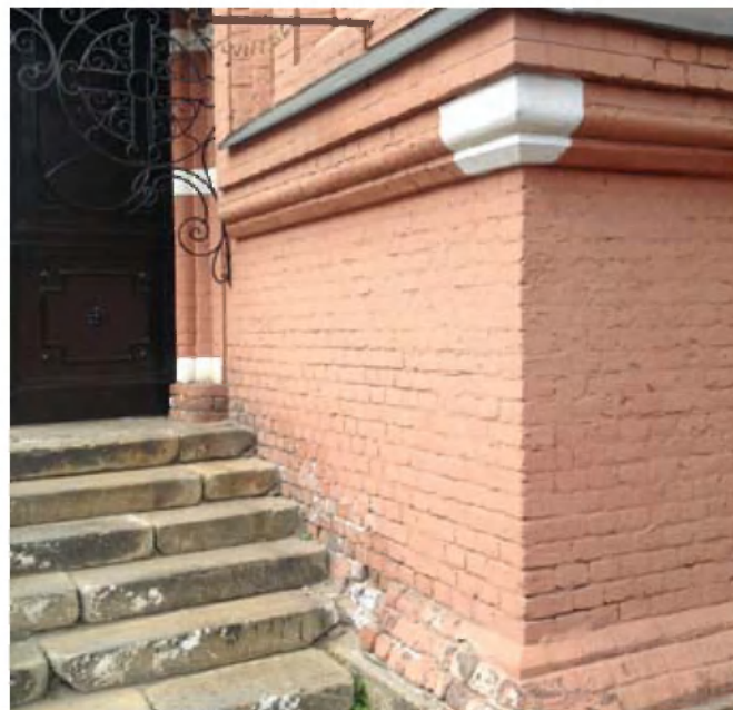
Разрушение кладки цоколя храма Всех Святых от внешнего увлажнения
