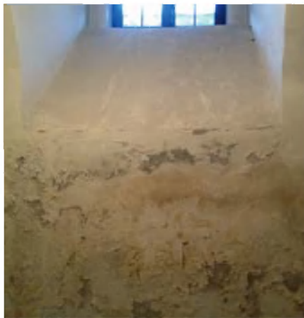
Шелушение окрасочного слоя и появление грибковых образований на влажной стене нижнего храма
